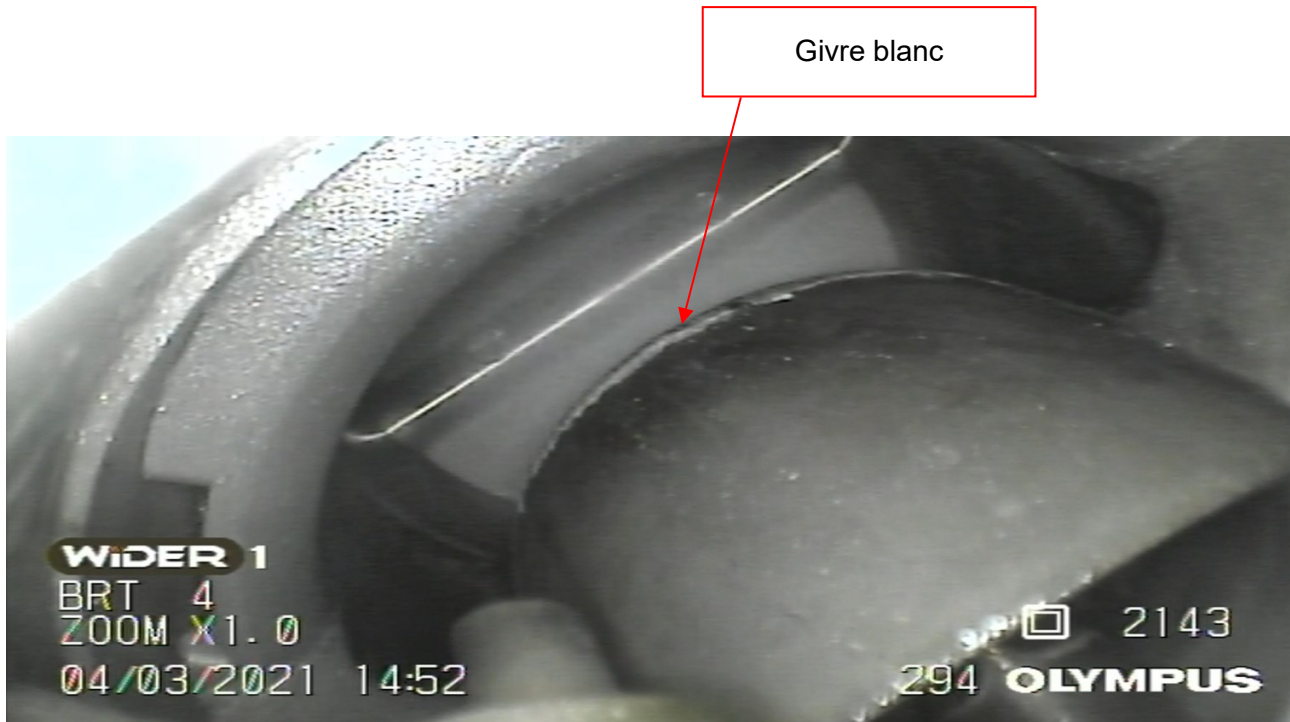
Figure 122 : Présence de givre blanc sur la surface extérieure du venturi Source : BEA
