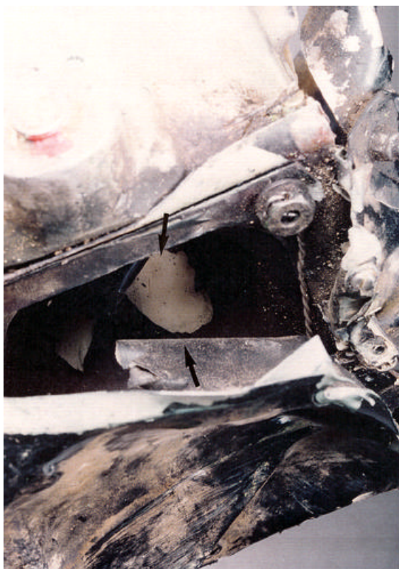
Photographie 3 : Morceau de peinture obstruant le venturi
