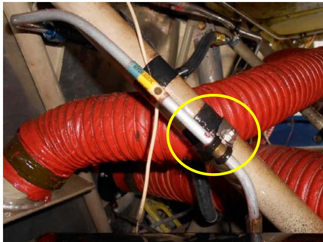
Localisation de la perforation sur la tuyauterie dans le compartiment de la batterie
