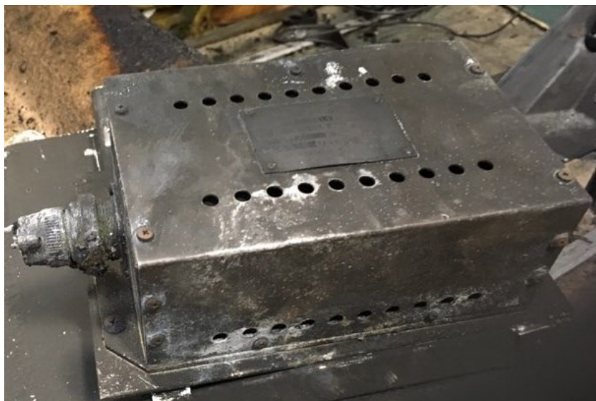
Figure 33 : Convertisseur 12 V - 24 V déposé de la paroi droite Source : BEA
