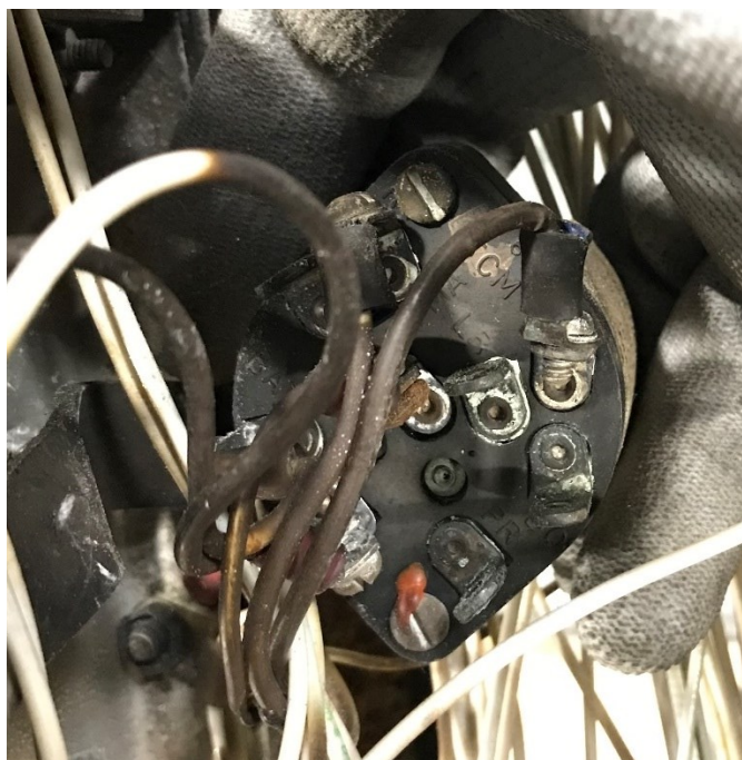
Figure 151 : Face arrière du commutateur de démarrage Source : BEA
