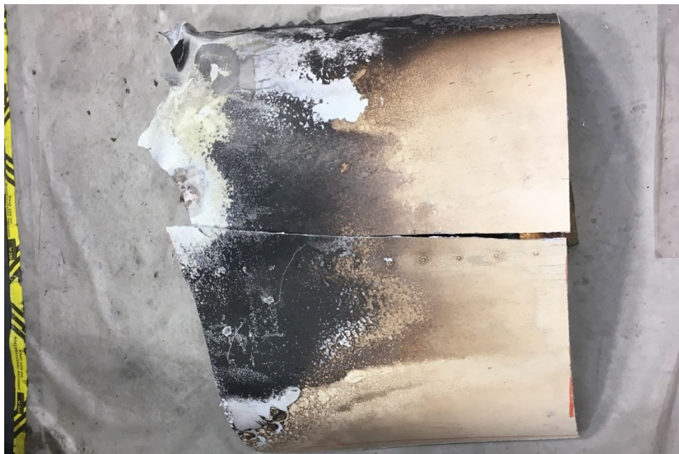
Figure 10 : Zone où la peinture externe de la tôle est endommagée ou détruite sur la partie supérieure de l'avion
