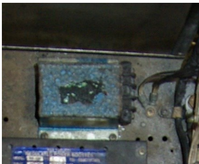
Figure 36 : Circuit Breaker en place sur le plancher cabine et non connecté électriquement
