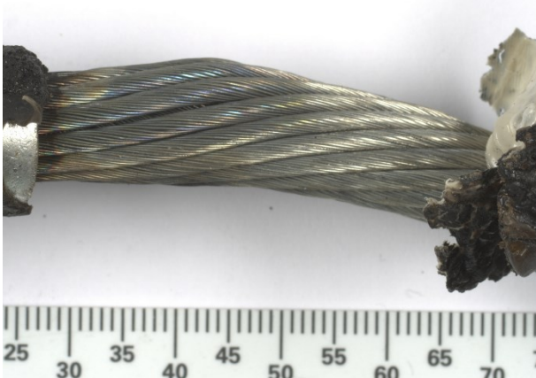
Figure 67 : Bleuissement du conducteur (échauffement du conducteur) Source : BEA
