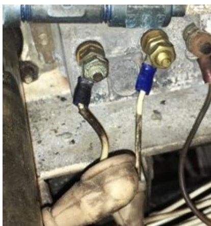
Conducteurs connectés à l'ampèremètre, situés derrière la planche de bord
