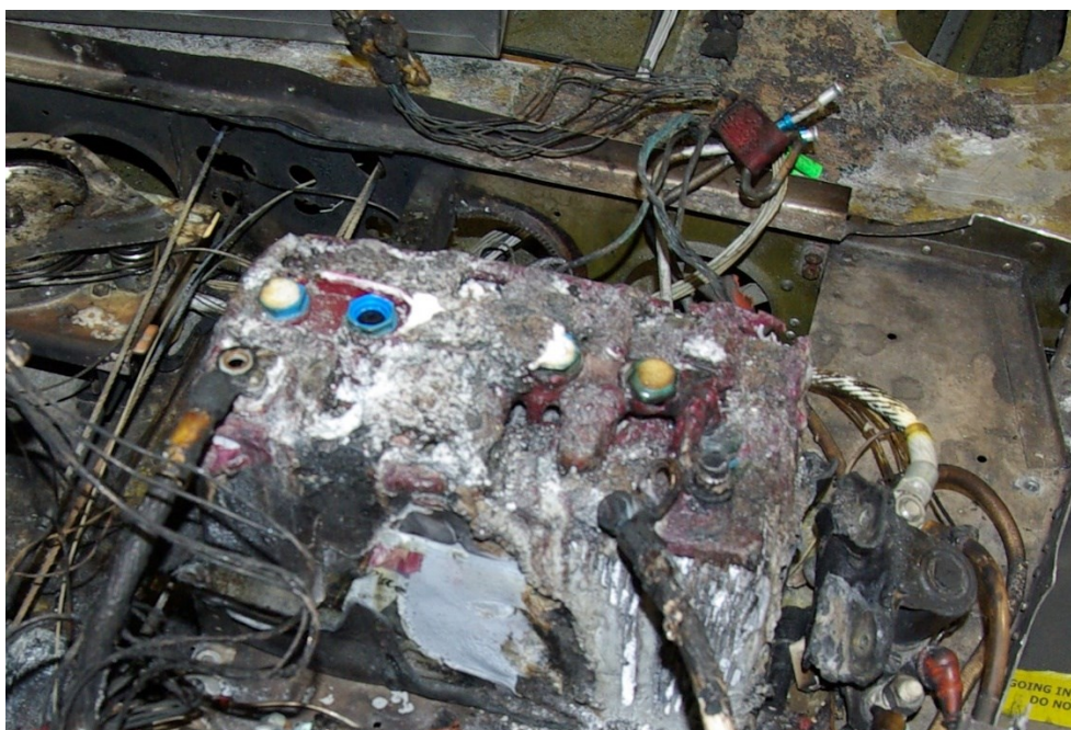
Figure 48 : Batterie Source : BEA
