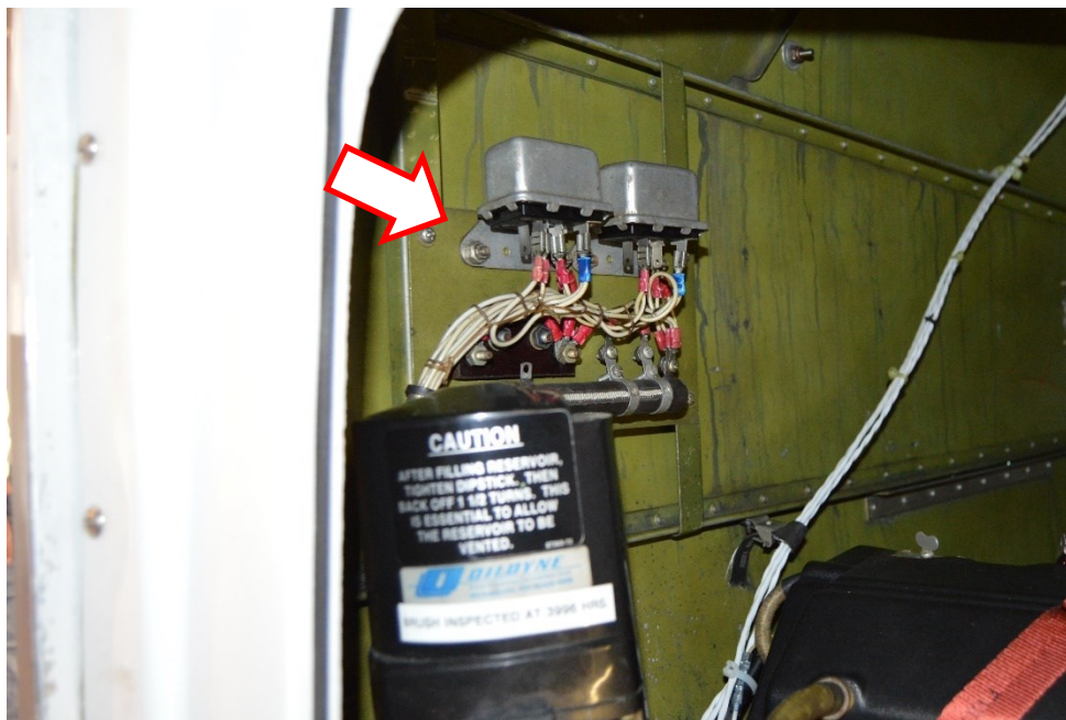
Figure 26 : Ensemble électrique situé sur la paroi droite Source : BEA
