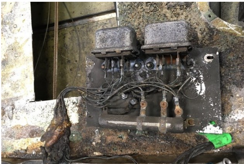
Figure 32 : Ensemble électrique déposé de la paroi droite Source : BEA
