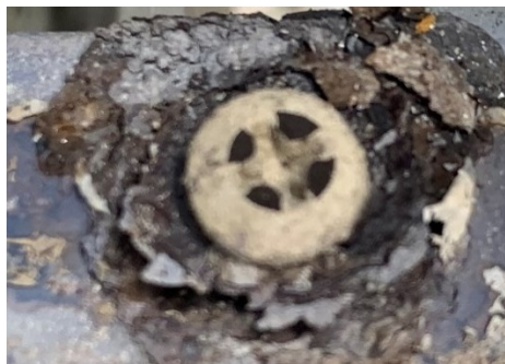
Destruction de la rondelle isolante
