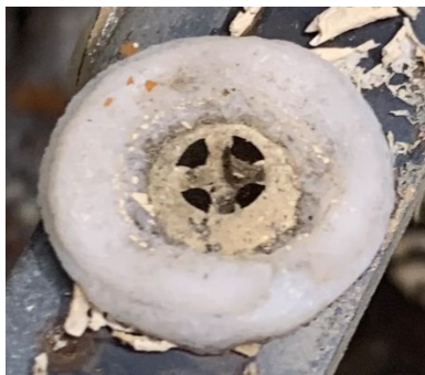
Ramollissement de la rondelle isolante
