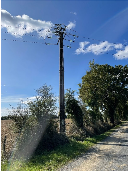
Figure 2 : un des deux pylônes entourant le site de l'accident (Source : BEA)
