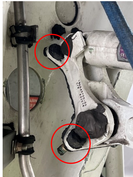
Figure 5 : boulons de fixation de la platine retrouvés endommagés (Source : BEA)
