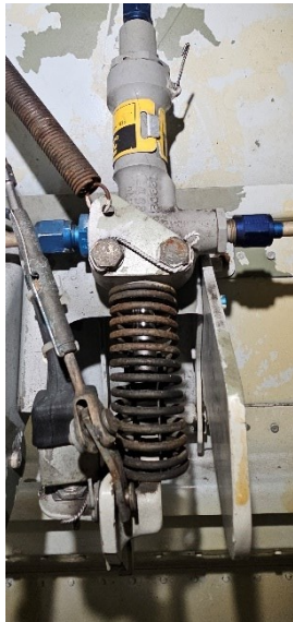
Figure 5 : traces de corrosion sur des ressorts du mécanisme du train d'atterrissage avant 23 (Source : R&O)
