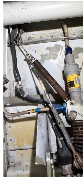
Figure 6 : protection anticorrosion (de couleur jaunâtre) absente sur les parois du puits du train d'atterrissage avant (Source : R&O)
